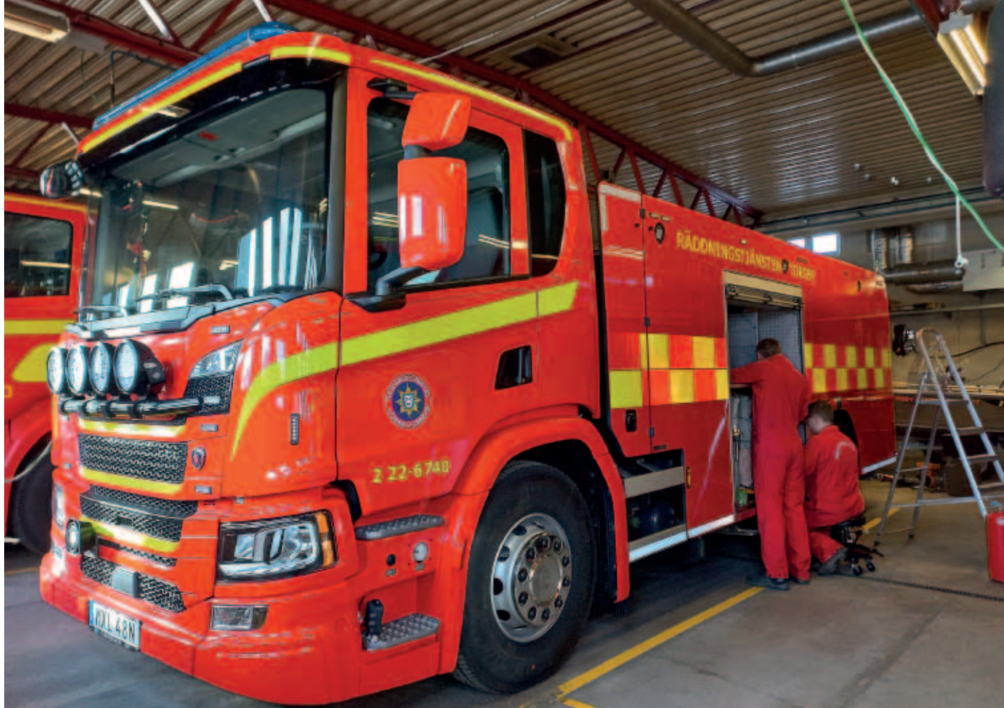
Niclas Haraldsson och Johan Westh bygger inredningen i den nya brandbilen. Foto: Ann Rundqvist
